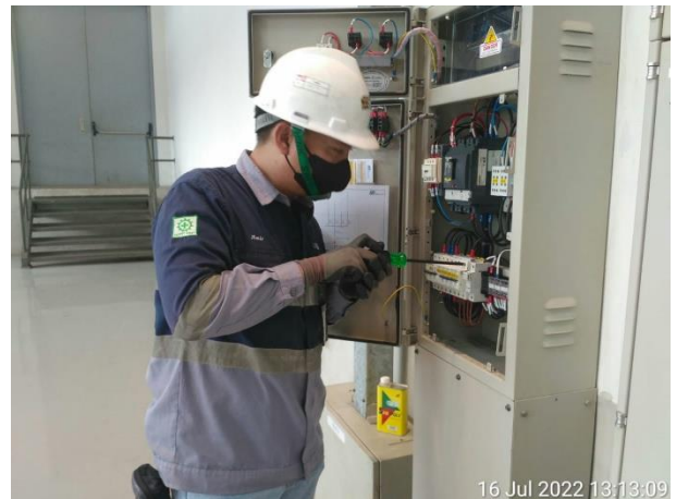
Pengecekan dan pemeriksaan Panel
