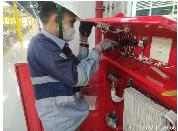
Pemeriksaan bulanan Indoor Hydrant Box
